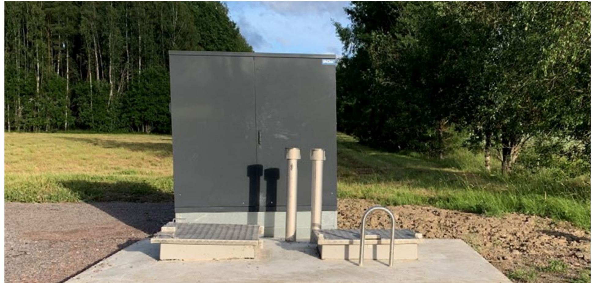
Esimerkki jätevesipumppaamosta (kuva: Sitowise Oy)
